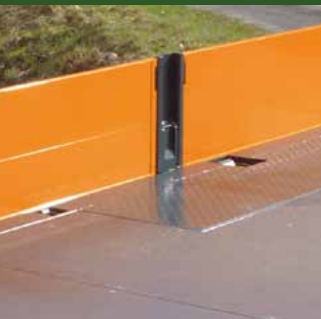
eingelassene Zurringe (nach UVV) mit einer Zugkraft je Stück von 2.500 daN oder 12.000 daN
