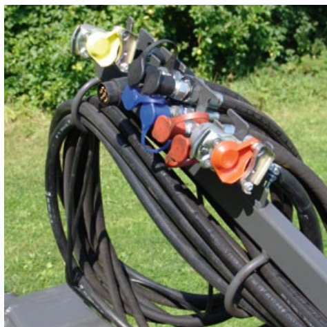
Saubere Anordnung der Hydraulik- und Luftleitungen
