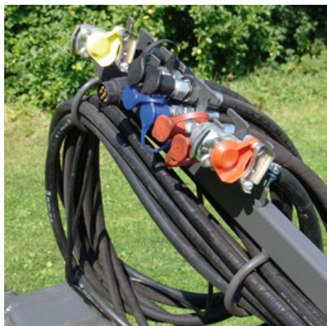
Saubere Anordnung der Hydraulik- und Luftleitungen
